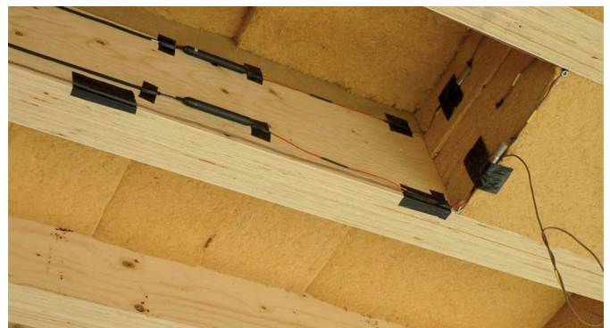
Bild 4 Sensoren zum Messen von Feuchte und Temperatur in den Gefachen (Quelle: STEICO) Moisture and temperature sensors with-in the frames (Source: STEICO)
