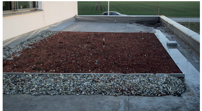
Bild 3 Flachdach-Oberfläche: teils mit heller Dichtungsbahn, teils mit Begrünung (Quelle: STEICO) Flat roof surface: partly with light-coloured sealing membrane, and partly with greening (Source: STEICO)
