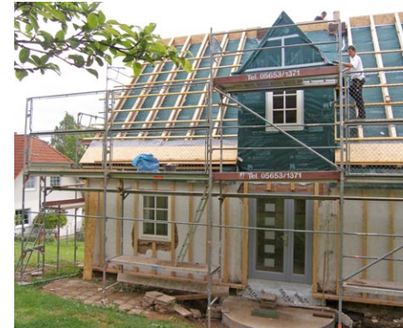
Das Gebäude mit angebrachten Tragelementen vor Beginn der Dämmarbeiten. Zwischenräume werden mit STEICOzell gedämmt.
