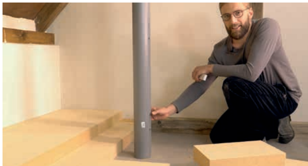
Auch ein frei im Raum stehendes Entlüftungsrohr ist kein Problem.
