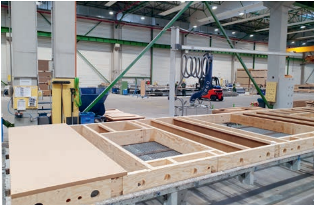
Das Riegelwerk aus STEICOjoist und STEICO LVL R wird mit der STEICOuniversal belegt, welche die Aussteifung während Transport und im Montagezustand sicherstellt
